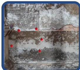
Parete, Area destra imaging termico
