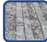
Parete, Area superiore destra. Sono evidenti lacune e distaccamenti superficiali
